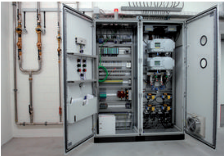
Steuerschrank der LowOx Anlage
