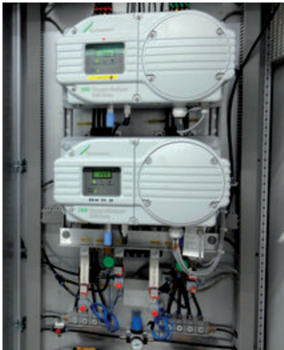
Redundantes LowOx Messsystem
