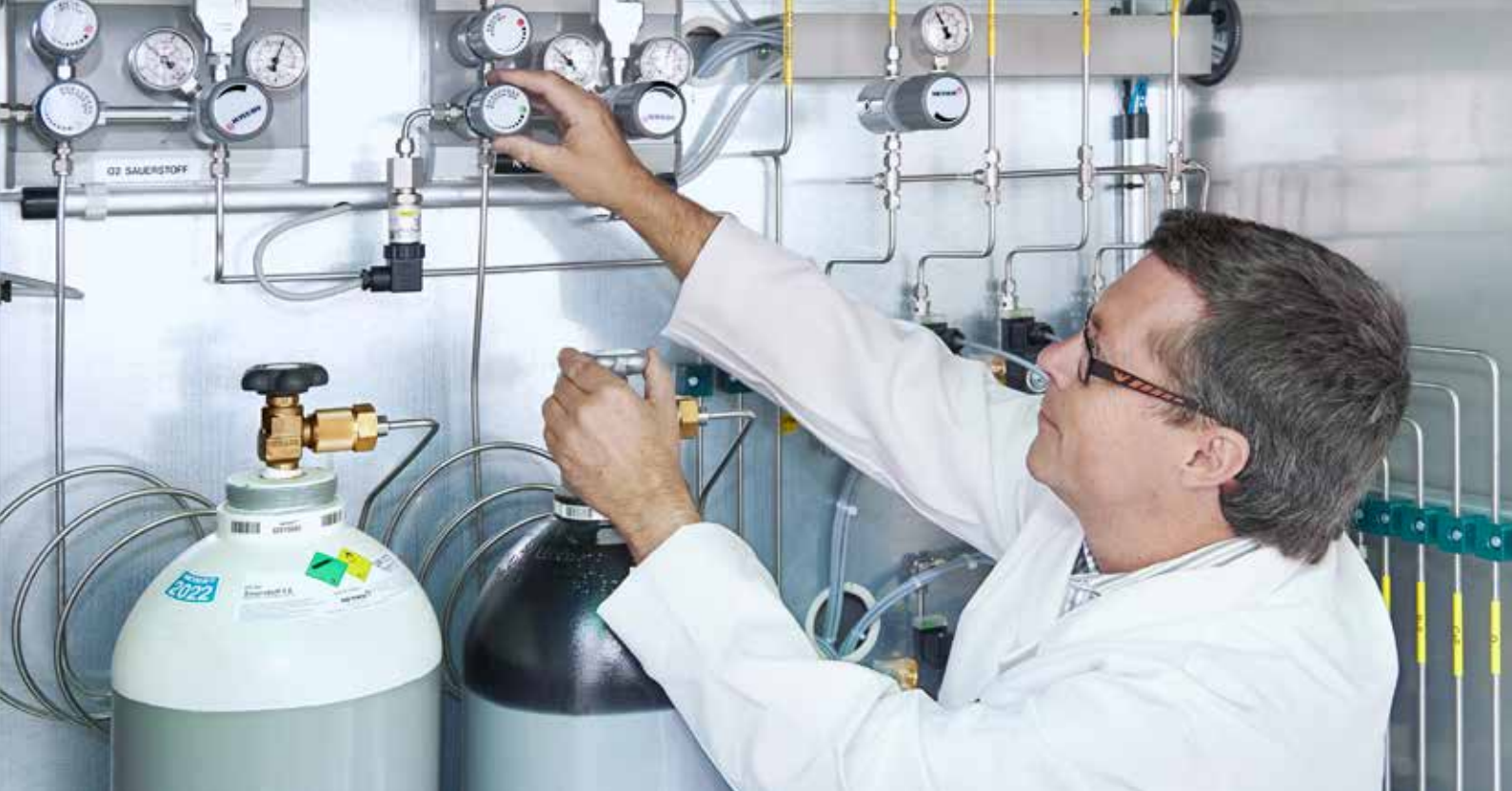
Systeme d'alimentation en gaz centralisé
