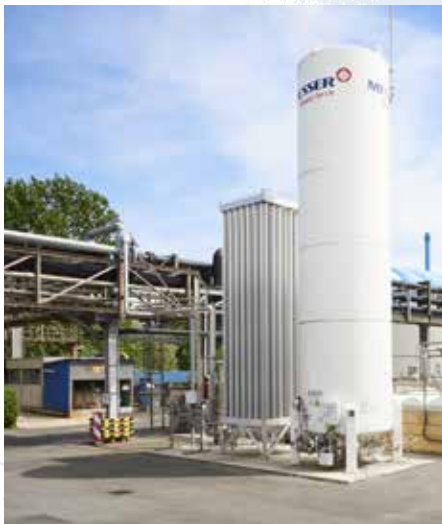
Tankinstallation beim Kunden
